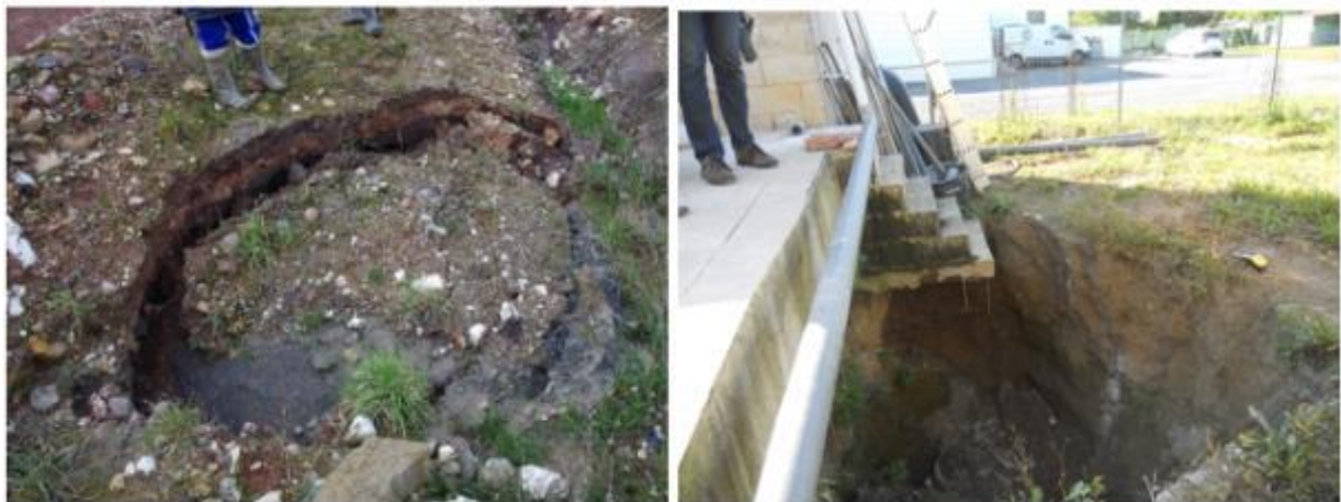
Figure 2. Exemples d'effondrements localisés au droit de cavités d'origine anthropique – source : Ineris
