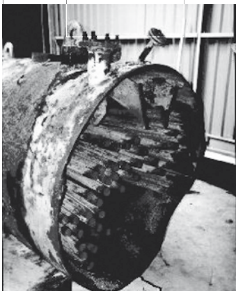
Élément de chaudière propulsé par effet fusée.
