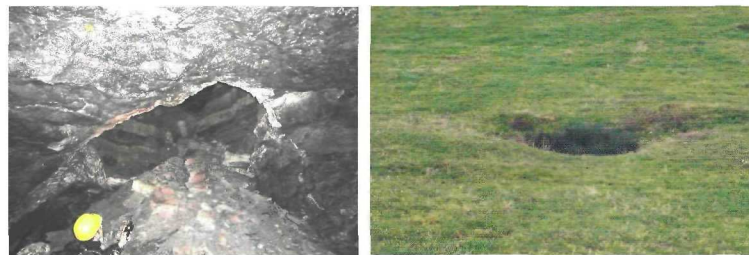
FIG. 1 – Exemple de formation d'un fontis au ciel d'une carrière (à gauche). Venue au jour (à droite).
