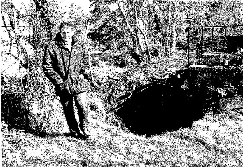
Photo 1 : exemple de fontis à Frémicourt (80)
