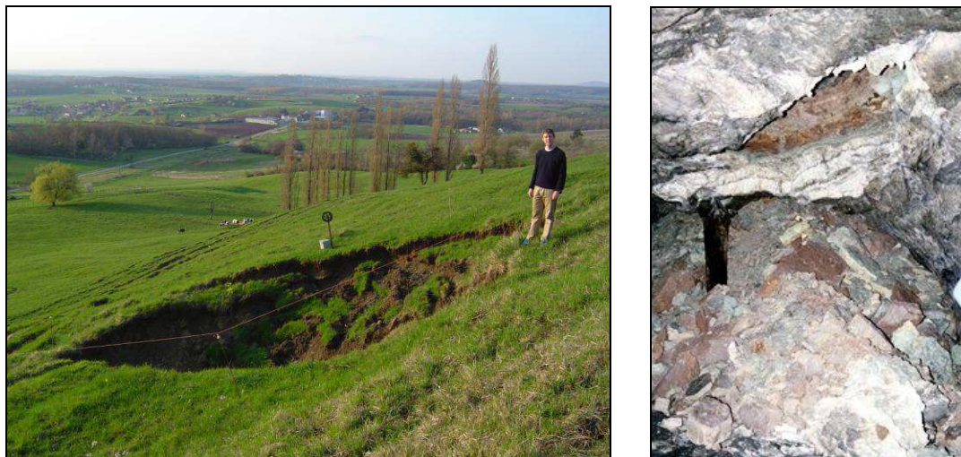
Figure n° 6 : Cuvette d'effondrement d'un fontis en surface à gauche et cloche d'effondrement en galerie à droite.
