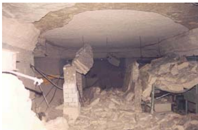
Figure 1 : Exemple d'éboulement du premier banc de toit dans une carrière de calcaire.
